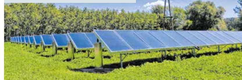
Nahwärmenetz wird über den Sommer zu 100 % mit Solarwärme versorgt.
