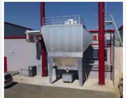
5.000-kW-Heizwerk zur Prozesswärmeversorgung
