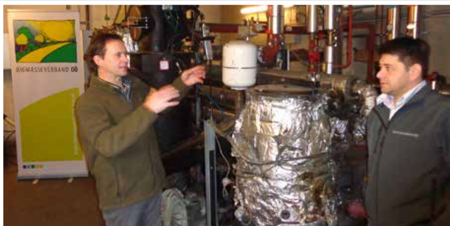
Mehrere Biomasse-KWK-Anlagen auf Basis der Holzvergasung von 30 bis 350 kW wurden in den letzten Jahren mit dem Biomasseverband OÖ realisiert und sind erfolgreich mit hoher Auslastung in Betrieb.
