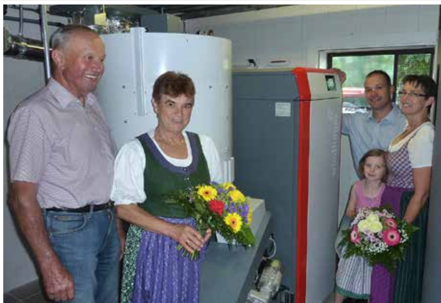
Familie Dicker freut sich über ihre neue Hackgutheizung. Sie arbeitet umweltfreundlich und hat ihnen dank Saugsystem den Neubau eines Hackgutlagers erspart.
