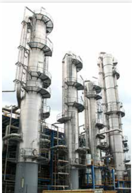
In Pischelsdorf befindet sich die einzige Bioethanol-Produktion Österreichs.
